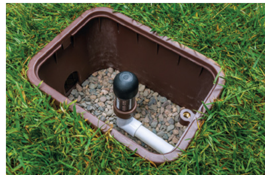
Válvula de alívio de vácuo/ar instalada
