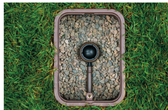
Válvula de descarga automática instalada
